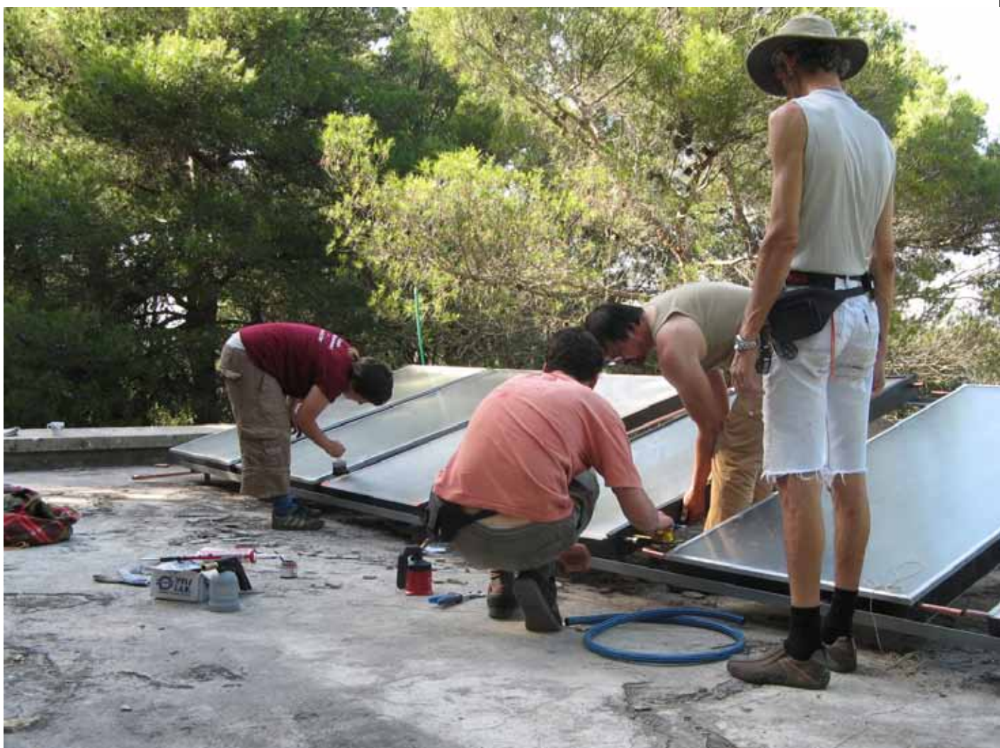
Solarni kolektori izrađeni na radionici održanoj u svibnju 2008. u sklopu Solarne akademije na Šolti i danas se koriste za grijanje tople vode u objektu
